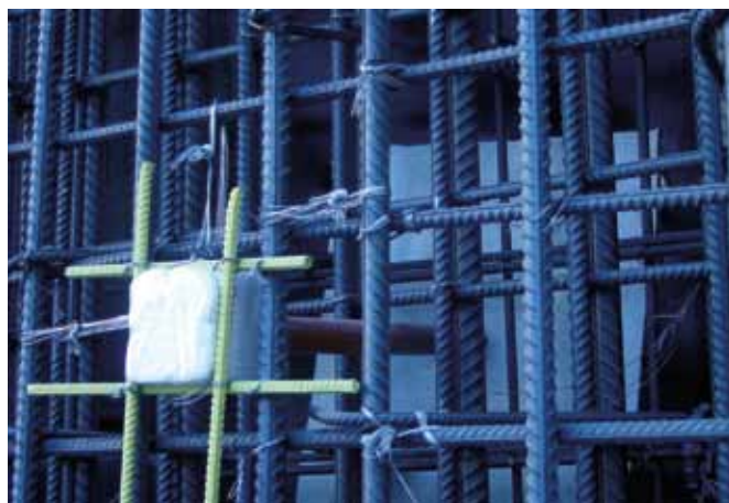
Protection de l'entrée du tuyau d'injection
