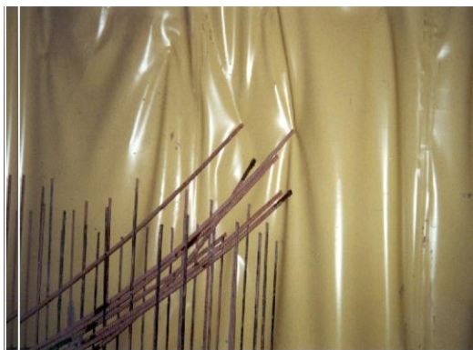
Les dangers des Barres de renfort pour la géomembrane
