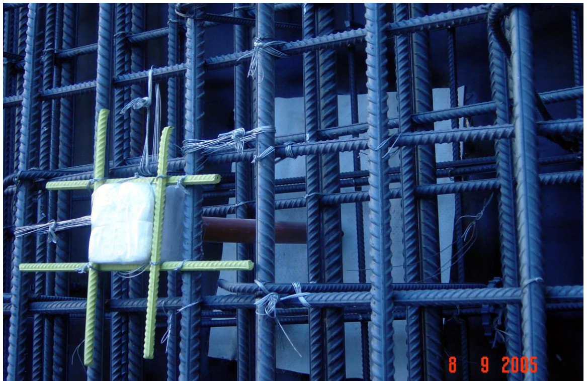
Entrada protegida de la tubería de inyección
