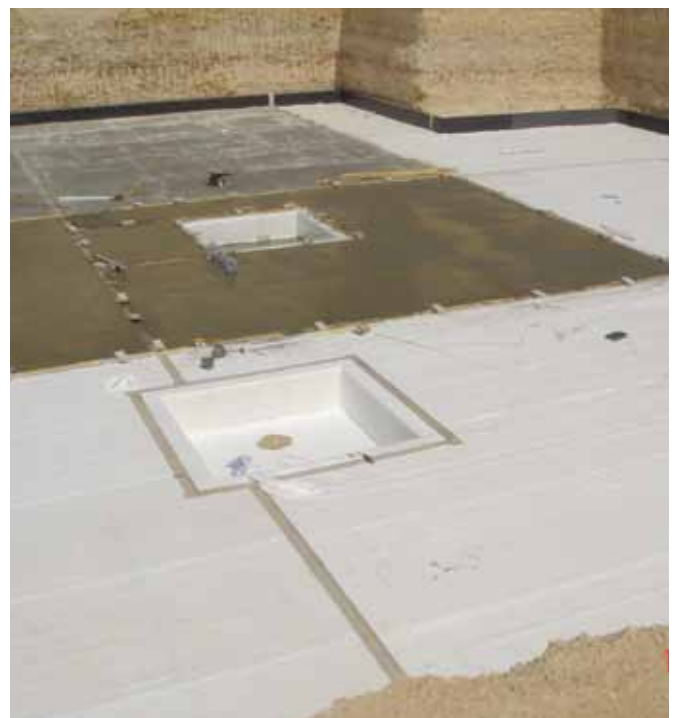
Losa protegida con Water Stop expuestos
