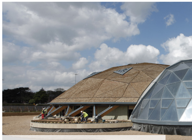
Centre sportif et de loisirs – Royaume-Uni Profils RENOLIT ALKORPLAN Solar utilisés comme base pour la fixation de tuiles en bois de cèdre et de panneaux en aluminium
